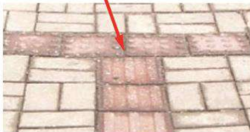
Foto 6: Exemplo de sinalização com piso tátil: um tipo indica rota e o outro tipo alerta para o perigo (obstáculo, interrupção da calçada, etc).
